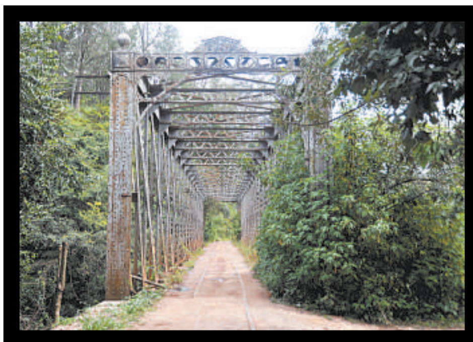
Trilhos praticamente sumiram sob a terra em ponte abandonada: estrutura subaproveitada
