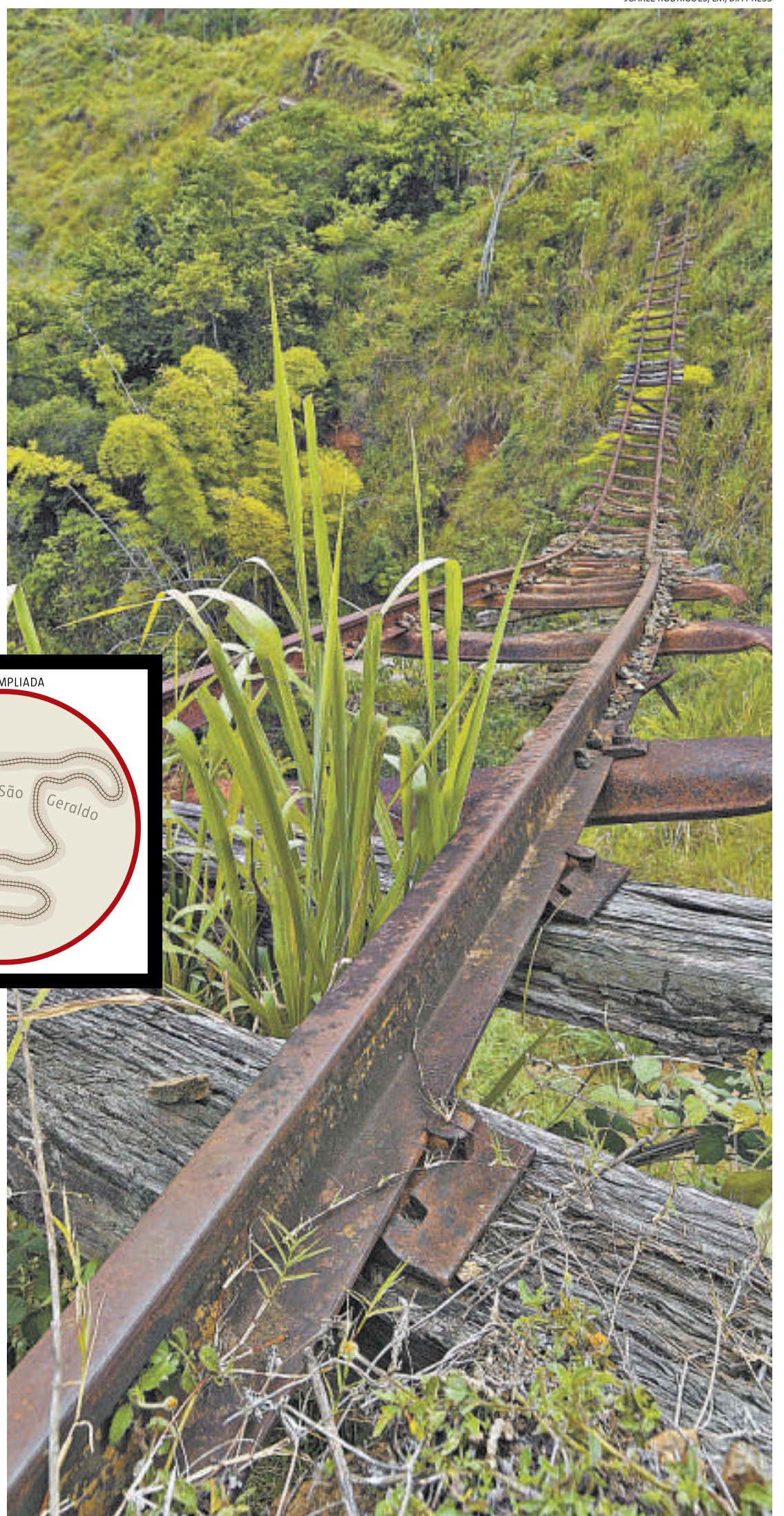
Abandonado por concessionárias e pelo Estado, acervo ferroviário é saqueado e sucateado em São Geraldo
